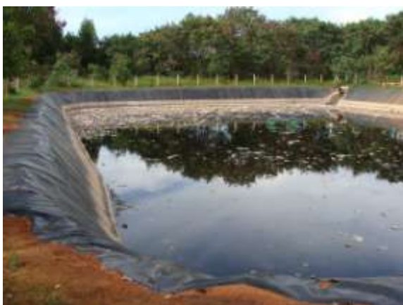
Lagoa principal de captação de chorume: Possui lona de vedação. Para não transbordar, o chorume é retirado dessa lagoa em caminhões ou por meio de bomba automática e despejado sobre os resíduos aterrados, para então escoar novamente.
